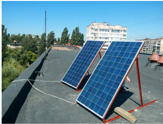
Рис. 3. Вузол ФМ енергоефективної університетської сонячної електростанції
